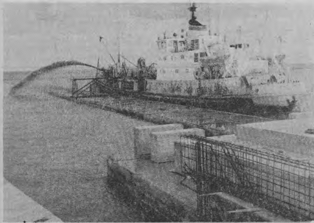
Równocześnie z dobiegającym końcem I etapu budowy rafinerii „D” „Gdańsk” — w Porcie Północnym trwają intensywne prace przy budowie przeladunkowo-palnego. Roboty koncentrują się przy piśmie do cumowania statków i wyładunku ropy. Trwa również układanie przewodów rurowych z Portu Północnego do rafinerii. Baza paliw płynnych przekazana zostanie do eksploatacji równocześnie z Gdańską rafinerią, tzn. w lipcu tego roku.
