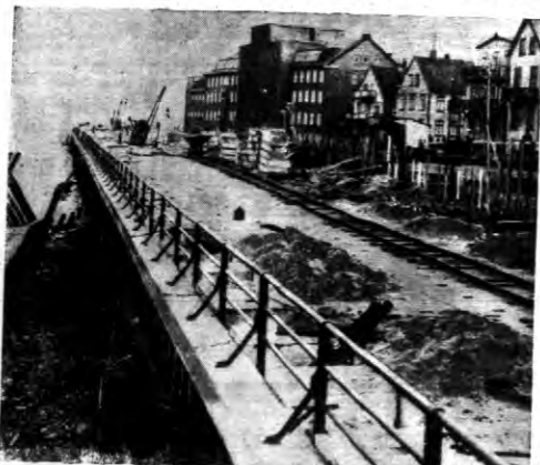
Na wyspie Helgoland przeprowadzono obecnie obszerne prace zmierzające do zabezpieczenia wybrzeża, przed działaniem fal.
