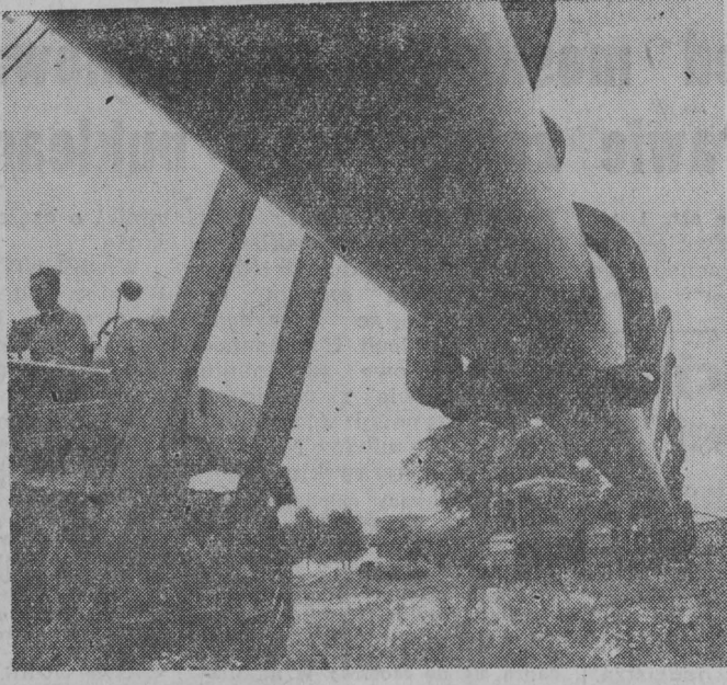
Budowniczo-rurociągu „Przyjaźń” postanowili wykonać do dnia 22 lipca połączenia rurociągu na granicy wschodniej i zachodniej z odcinkami ułożonymi na terytorium ZSRR i NRD. Wykonanie tego zobowiązania jest ważnym etapem w harmonogramie umowy przewidującym uruchomienie rurociągu przed nadziejnym mrozem. NA ZDJĘCIU: fragment prac przy układaniu rurociągu. CAF — fot. Czarnogórski
