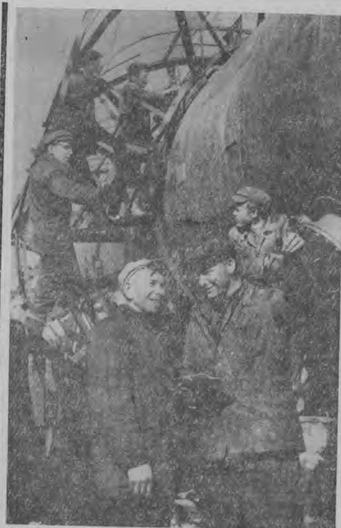
Ślusarze-montażyci z budowy Zakładów Azotowych w Grodnie są w dobrym nastroju. Dobra kosa montaż 46-metrowej kolumny absorberującej do produkcji kwasu...
