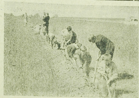
Młodzież ze Szkoły Podstawowej w Doktorcach przygotowuje rezygnację, w którym zostanie uložony kabel telefonowy z Doktorcami
