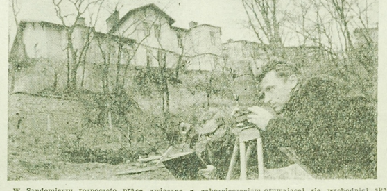
W Sandomierzu rozpoczęto prace związane z zabezpieczeniem otaczającej się wschodnią ścianą miasta, Ciesielski tych prace kieruje doc. dr Zbigniew Sziracki z Arkuskiej Akademii Górniczo-Hutniczej. CAF Wawrzyńkiewicz
