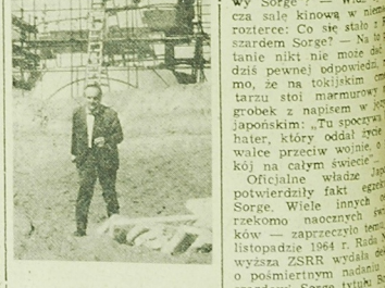
Prace przy budowie pomnika Bohaterów Westerpród. Posuwają się na dobre. Pomnik, w którego budowanie dopiera prof. inż. Adam Haupt, projektant pomnika.
