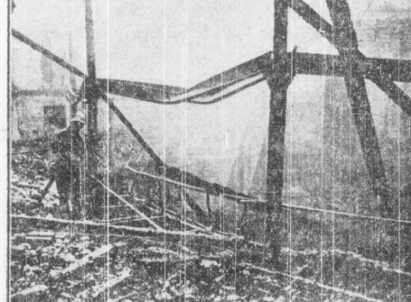
W Nicei w teatrze „Eldorado” wybuchł pożar, który strawił doszczętnie całą gmach. W gmachu tym odbywały się ciągnięcia narodowej loterii francuskiej. Budynek spłonął w przeddzień ciągnięcia.
