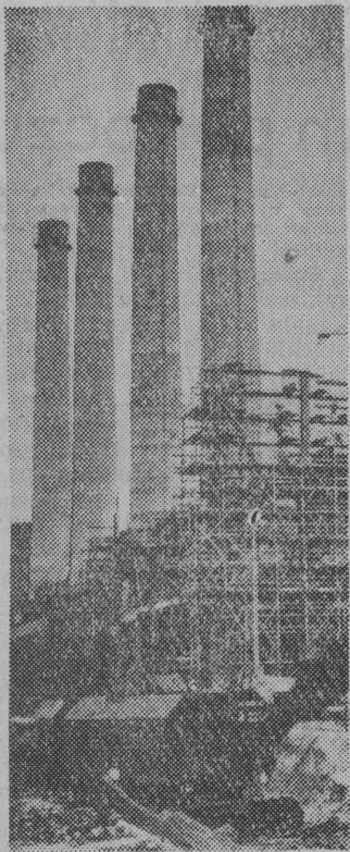
Elektrownia Berzdorf, której budowę rozpoczęto w roku 1956, będzie gotowa w roku 1963. Ogólna jej moc wyniesie 500 megawatów. Trzy pierwsze agregaty dają już prąd, czwarty zaś zostanie oddany do użytku w najbliższym czasie. Po ukończeniu budowy czynnych będzie 6 agregatów, z czego dwa ostatnie posiadać będą większą moc. Fot. — CAF
