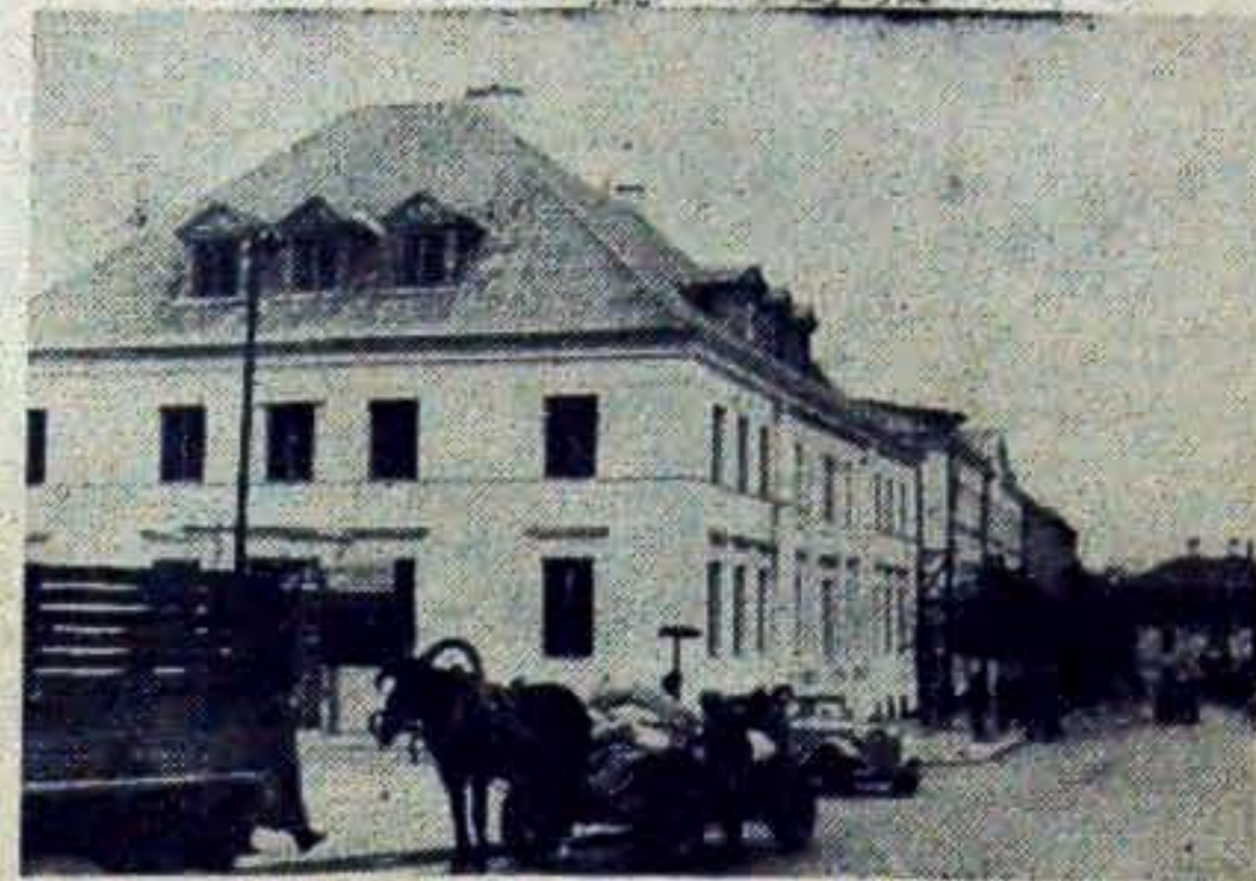
W odbudowanym z ruin zabytkowym budynku przy ul. Kilińskiego znajdzie pomieszczenie Biblioteka Miejska w Białymstoku. Na zdjęciu: gmach Biblioteki Miejskiej, w którym trwają jeszcze prace wykończeniowe.
