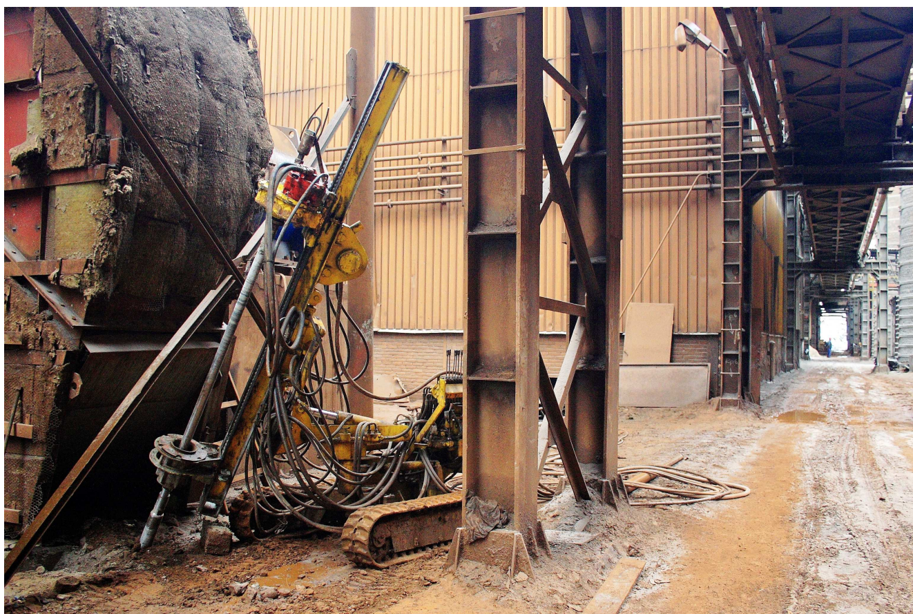
Rys. 2. Formowanie kolumn iniekcyjnych z wykorzystaniem małogabarytowej wiertnicy w obrębie istniejącej konstrukcji przy znacznie ograniczonej przestrzeni roboczej (fot. własna)
