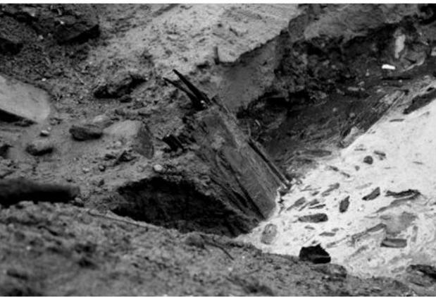
Rys. 3. Warstwy węgla brunatnego oraz namulów i osadów organicznych pod badanym nasypem drogowym
