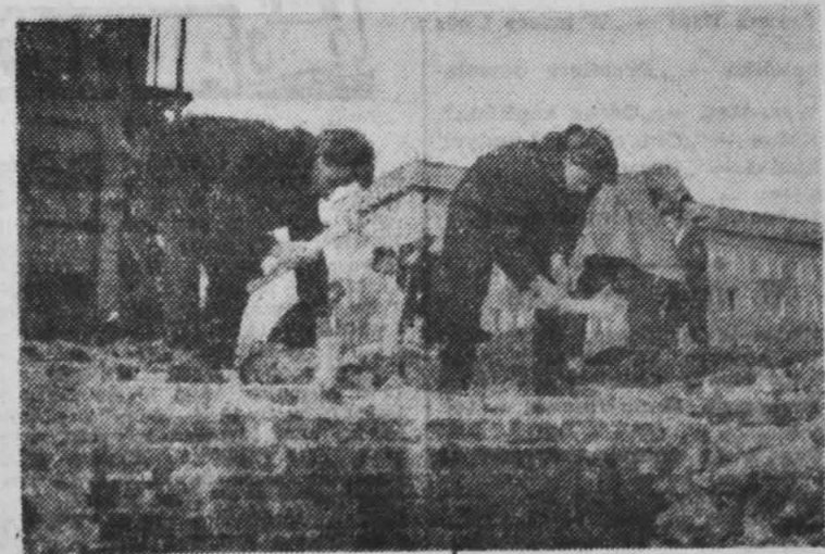
Korzystając ze sprzyjającej pogody, na białostockich budowach ruch nie ustaje ani na chwilę. Miastu przybędą nowe domy, izby mieszkalne. NA ZDJĘCIU: Brygada murarska w czasie pracy.
