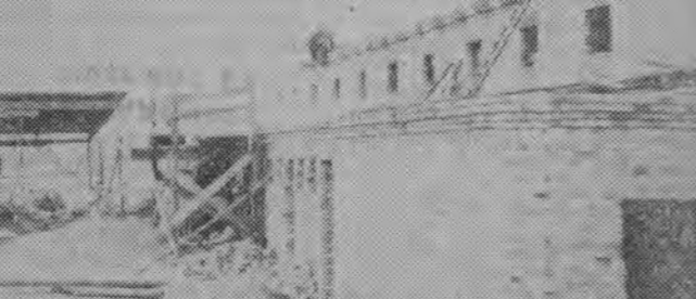
W pięciu kręgach cegielni w Zlotorii będzie można roczną wypaść ponad 7 milionów sztuk cegieł. Co ciekawe, wysoki pionowy komin zasłaniają, białasy komin. W cegielni działają kilkanaście pieców...
