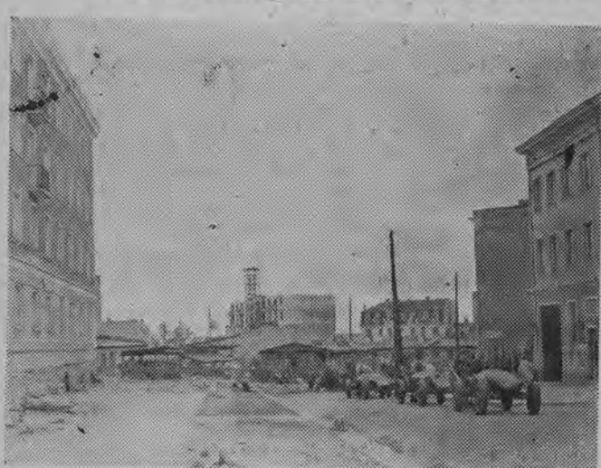
Ulica Nowy Świat doczekała się wreszcie porządknej jezdni i chodników. W przyszłości Nowy Świat będzie dojazdowa ulica łącząca Lipową i trasę WZ. NA ZDJĘCIU: roboty drogowe na jezdni.
