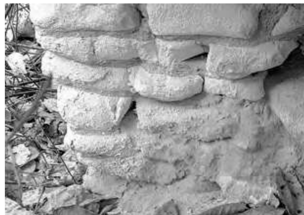
Rys. 2. Korozja solna muru wykonanego z kamienia wapiennego (Ważny i Karyś, 2001)
