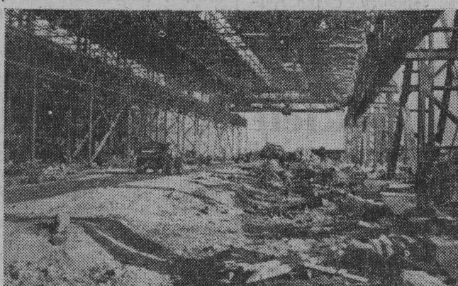
NA ZDJĘCIU: fragment budowy walcowni blachy. Będzie to największa hala kombinatu. Długość jej wyniesie kilkaset metrów. Fot. — CAF
