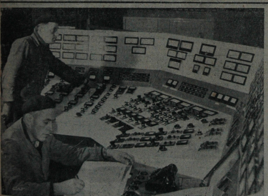
W elektrowni Adamów, po raz pierwszy w Polsce, w zakładach tego typu wprowadzono w nauki planując politykę sterowniczą z urzędzaniem i tezwizyjnymi. Celem było ukończenie tego zakładu energetycznego nastąpi w roku 1986. NA ZDJĘCIU: próby palenistwa sterowniczo. CAF — fot. Sztyrecko
