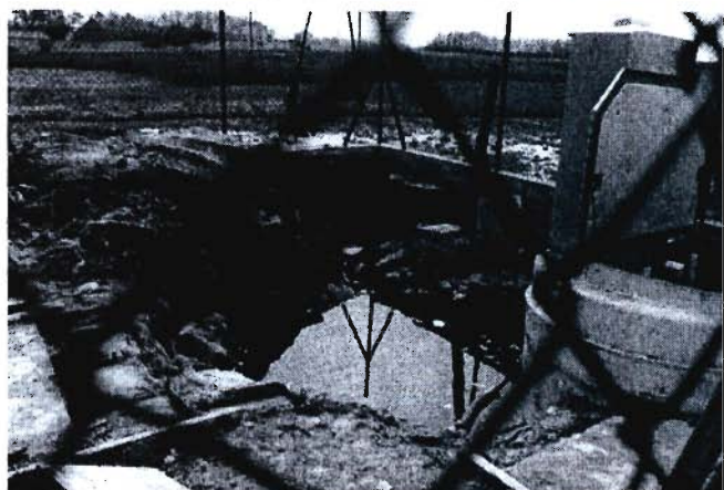
Rysunek 8. Awaria głównej przepompowni ścieków „P5”, zlokalizowanej przy ul. 1-go Maja
