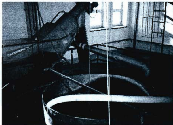
Rysunek 4. Sito i piaskownik - widok przedstawia nieoczyszczone ścieki płynące przelewem
