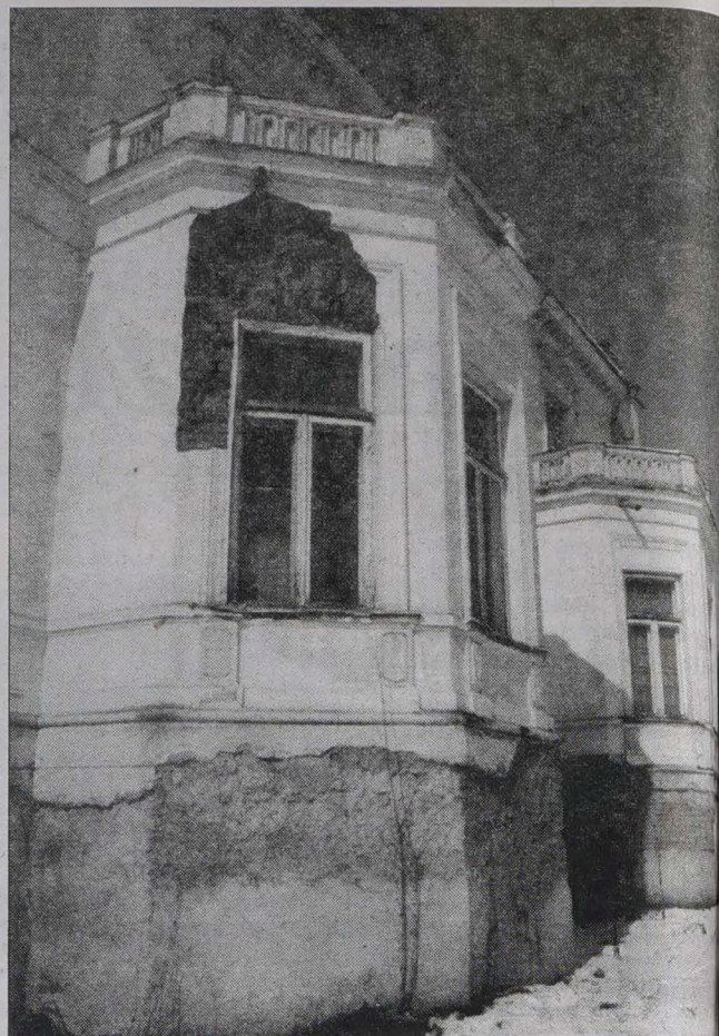
Być może uda się w tym roku rozpocząć kapitalny remont Pałacu Lubomirskich w Dojłidach, który znajduje się w bardzo złym stanie
