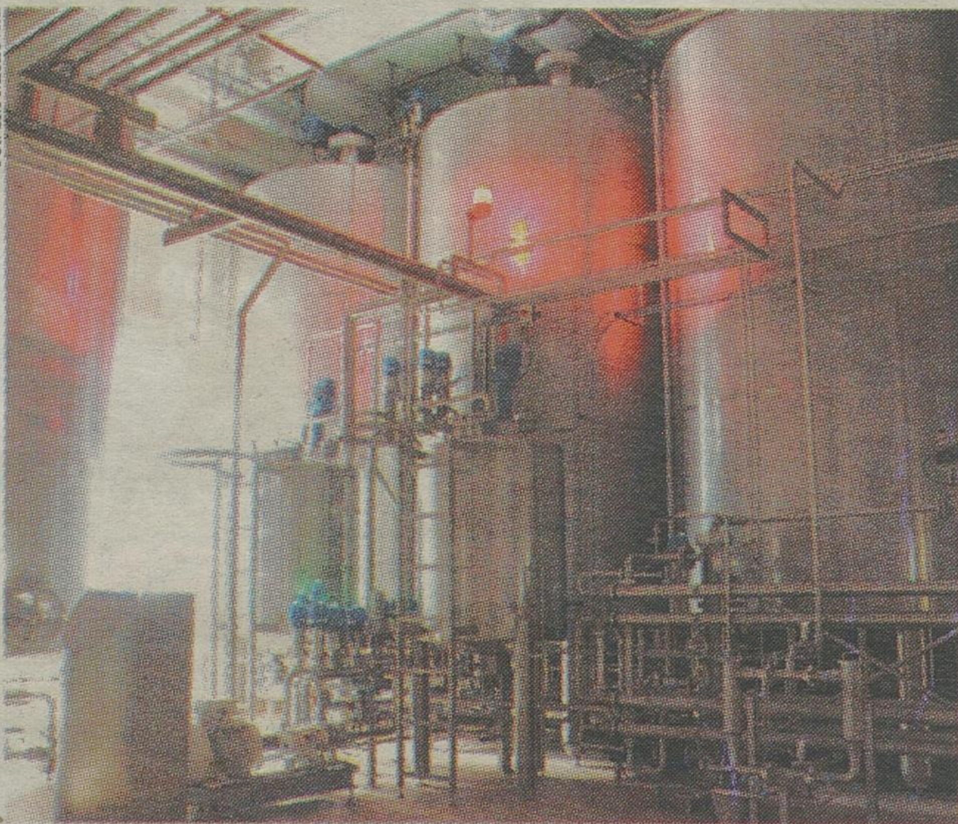
Instalacja w nowej proszkowni przygotowana jest do uzyskania w ciągu doby ok. 40 ton serwatki w proszku
