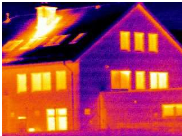
Rys. 2. Zdjęcie domu tradycyjnego wykonane kamerą termowizyjną – najczęstsze straty ciepła poprzez wentylację okna i niedocieplone przegrody
