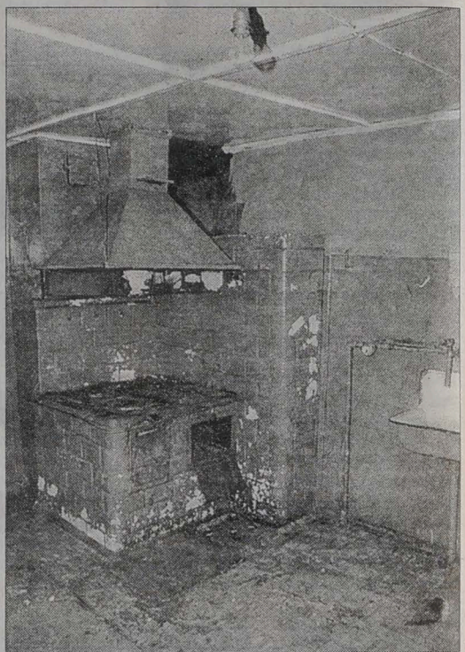
Niektórzy mieszkańcy Brańska oburza się, że mieszkanie komunalne przy ul. Sienkiewicza 42 stoi puste. Rok temu wykwaterowano z niego lokatorkę do innego lokalu. Mieszkanie jest zagrzybione i zimne, pękają ściany.
