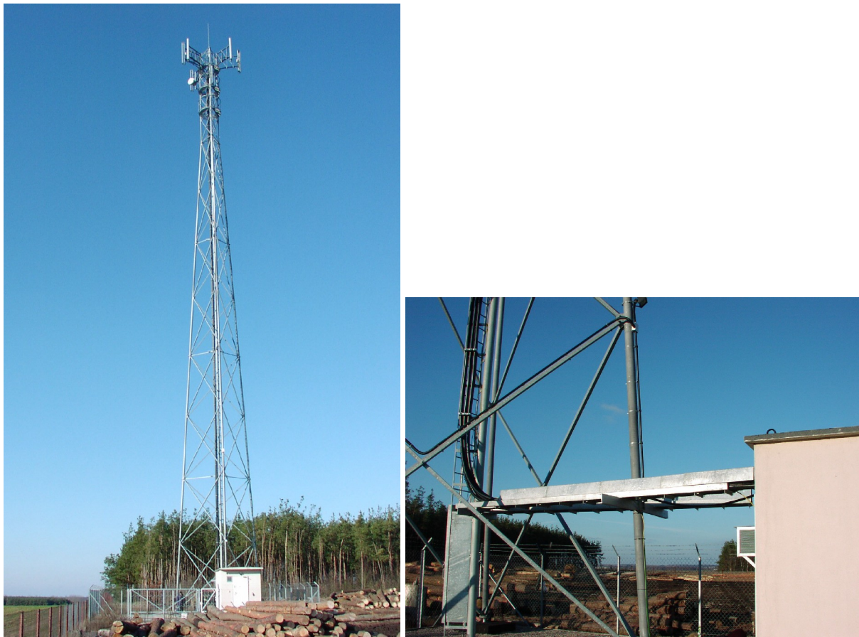
Rys. 5.1. Stacja bazowa GSM – widok ogólny
