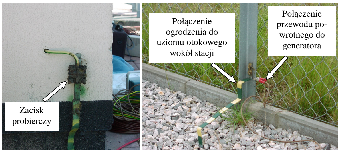
Rys. 5.5. Zacisk probierczy pod szyną technologiczną (po lewej); połączenie ogrodzenia do uziomu otokowego wokół stacji oraz przewód powrotny do podłączenia generatora (po prawej)
