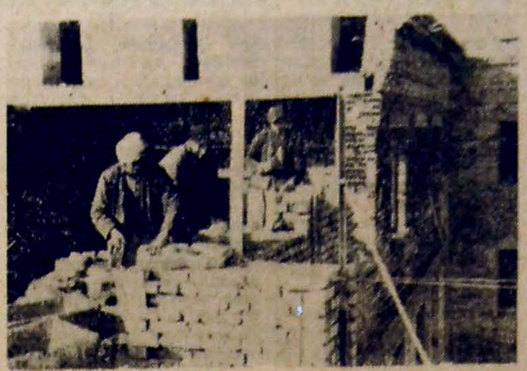
Trójka murarska ob. Kryńskiego, pracująca na budowie nr 33 ZOR, blok nr 42, wykonuje przeciętnie 220 procent normy. Dobrze stara się pracować nie tylko murarz Kryński ale także pomocnicy Tyszkiewicz i Dworzyczyk. Na zdjęciu: przodująca trójka Kryńskiego przy pracy. (Hr)
